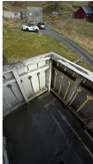
Oversikt balkong 2 etasje. Svertesopp på rekkverk. Metallplater på gulv er rustet og har malingavskalinger.
