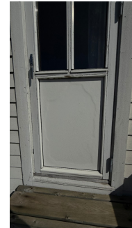
Balkongdør 1 etasje, værslitt og synlig svelling i dørbblad.-
