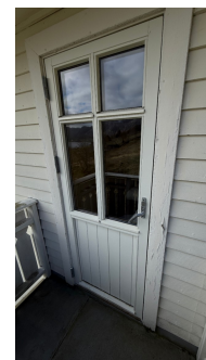
Balkongdør 2 etasje. værslitt omramming, vanskelig å åpne og lukke
