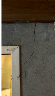
Sprekk i murpuss ved dør, innvendig i underetasjen.
