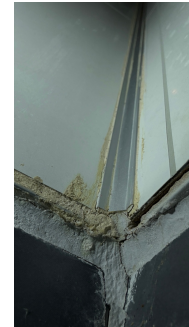
Noe manglende silikonerings i mellom baderomsplate og alulist.
