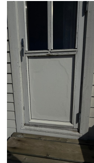
Balkongdør 1 etasje, værslitt og synlig svelling i dørblad.-
