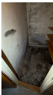
Synlig fuktskjolder og saltutslag på vegg og gulv
