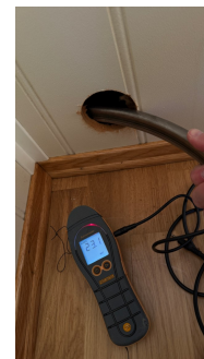
Fuktmåling i nedre del av stender på innforet vegg mot terreng.
