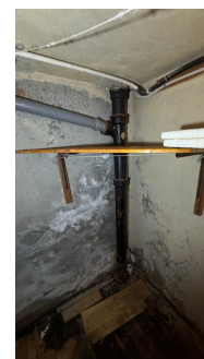
Rom med råteskadet tregulv, synlig saltutslag på vegg.
