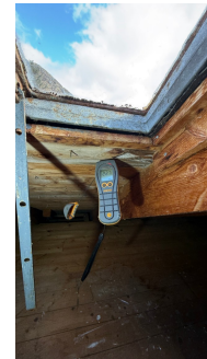
Forhøyede fuktmåling i området rundt vindu.
