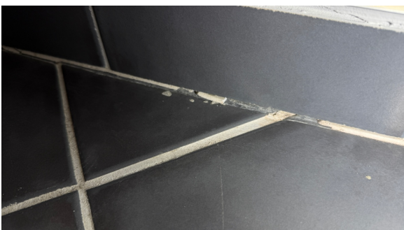
Sprekke i fuge, feil type fuge i overgang mellom gulv og sokkellist
