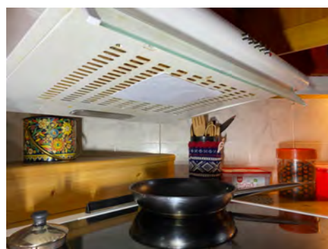
Funksjonstest av ventilator.
