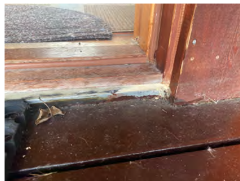
Manglende beslag i nedkant/utett pakning.
