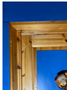
Det er påvist avvik som tilsier at det bør foretas tiltak på enkelte dører.
