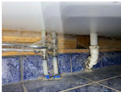
Ikke fagmessig rørgjennomføringer, ingen synlig mansjett/membran.
