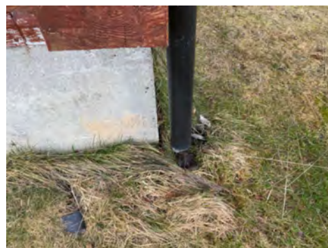
Manglende tilkobling av nedløpsrør til grunn.
