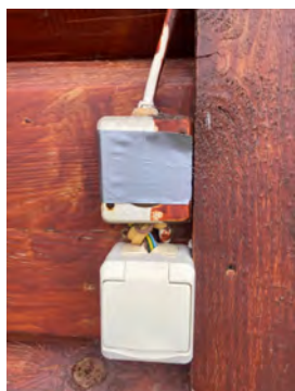
Utvendig stikkontakt, manglende deksel, synlige ledninger.
