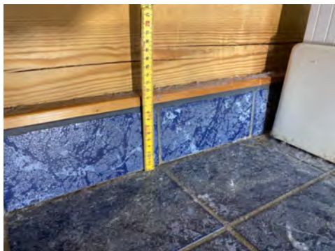
Manglende fugging mellom vegg/gulvflis.
