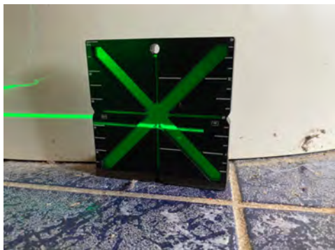
Måling av fallforhold til kabinett
