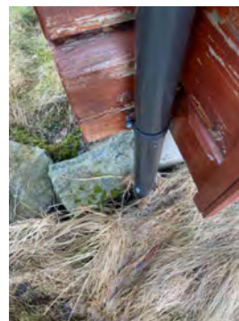
Ingen synlig drenering mot grunn.
