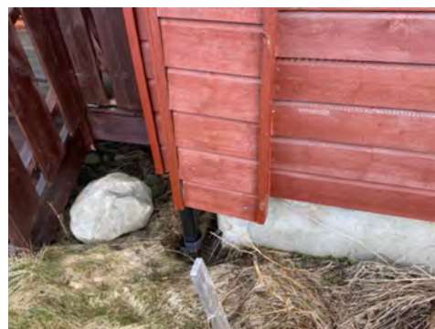
Enkelte nedløpsrør er tilkoblet rør til grunn.
