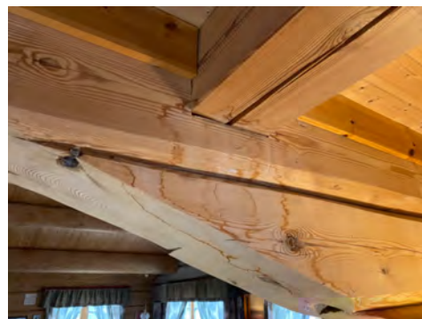
Fuktskjolder mellom gang/stue.
