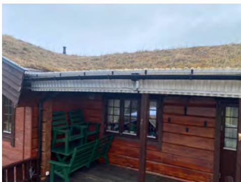
Manglende beslag mot takrenne.
