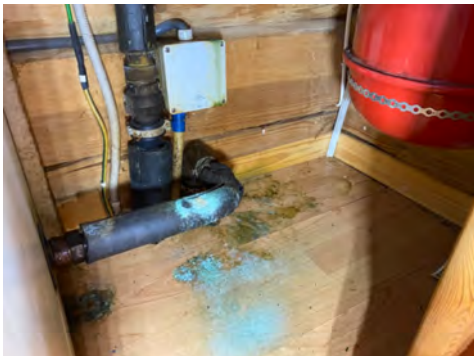
Lekkasje på rørinntak.
