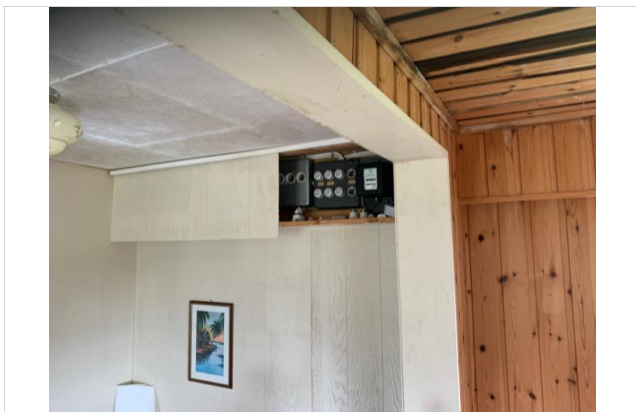
El. frakoplet ved sikringer - bør frakoples bygningen
