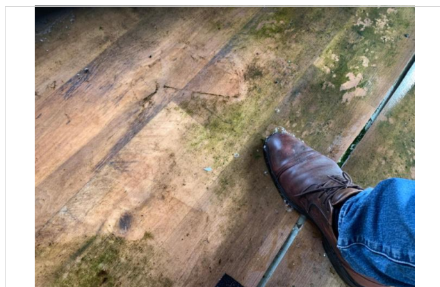
Gulv stue - full fuktoppløsning, fare for å trække igjennom
