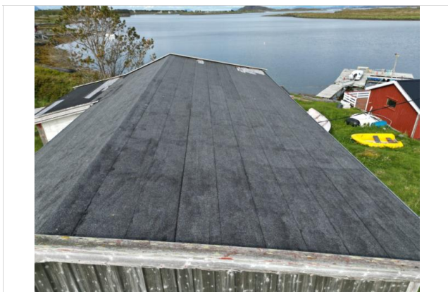
Tak/taktekke er dels revet av
