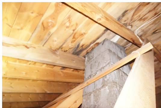
Fuktmerker på sutaksbord rundt pipe.
