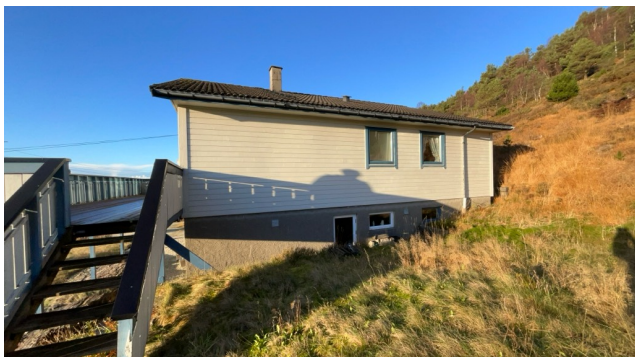
Ikke montert snøfangere-
