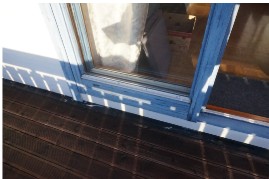
Skyvebalkongdør er fuktskadet og karmen har sprekker
