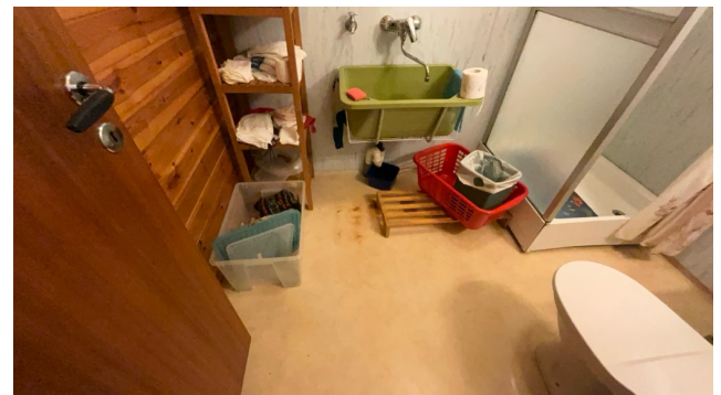
Bad, svimerker på belegg.
