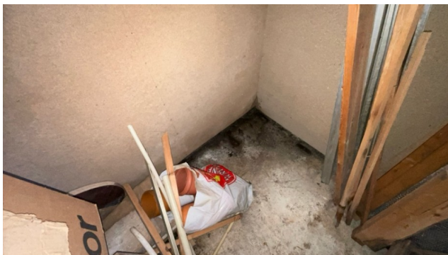
Vann på gulv i kjeller
