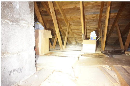
Fuktmerker på sutaksbord ute ved raft.
