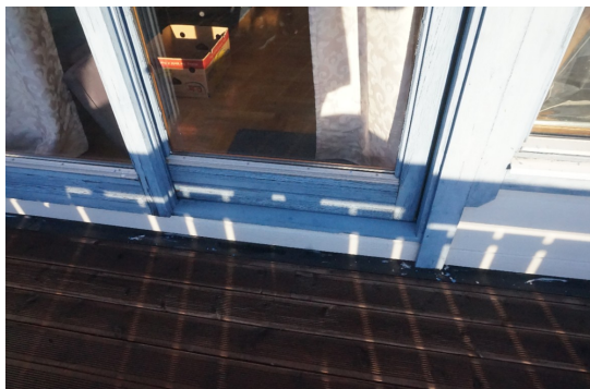
Skyvebalkongdør er fuktskadet og karmen har sprekker
