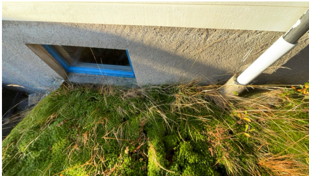
Ikke montert grunnmursplast
