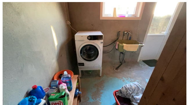
Skyllekar og opplegg for vaskemaskin.
