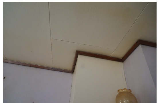
Fuktskade på takplater ved pipe.
