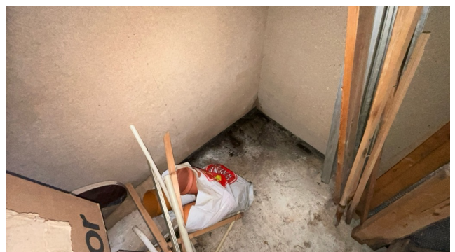
Vann på gulv og fuktskadet utforing.
