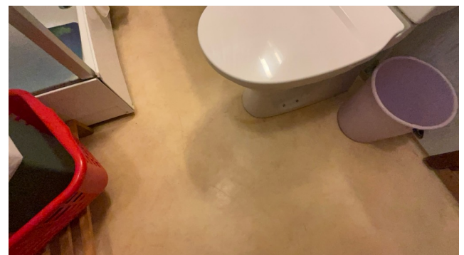
Belegg er løst fra underlaget.
