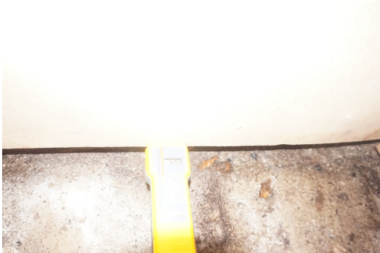
Måling av fukt i bunnsvill viser over 40% fuktighet
