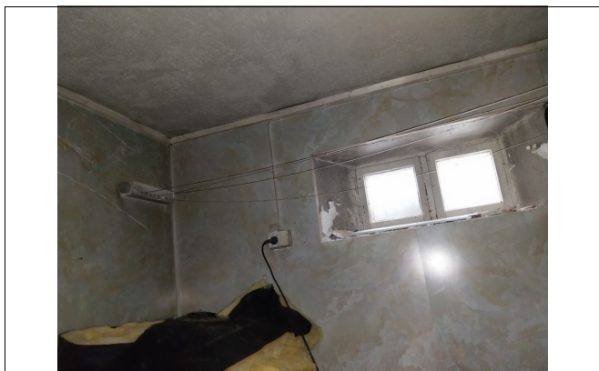
Kjeller; Bad / dusj / vaskerom. I dårlig stan
