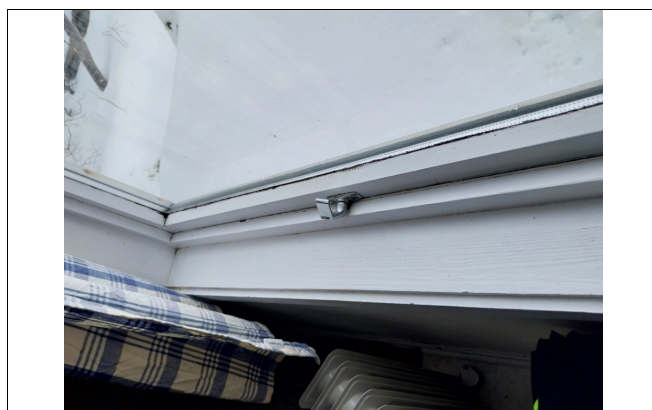
1.etg; vindu lar seg ikke lukke igjen
