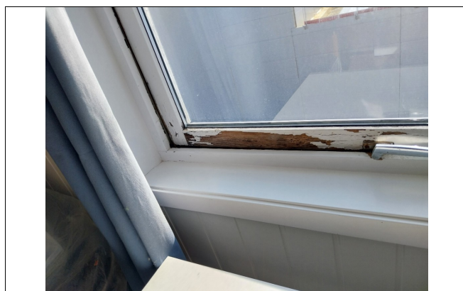
2.etg; råteskadet vindu.
