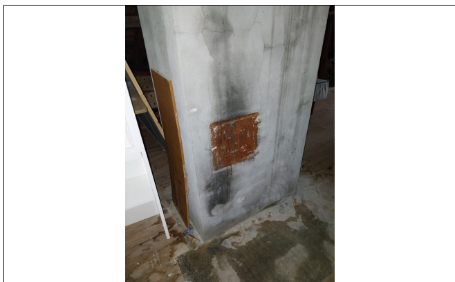
Pipe 2; ny feieluke må monteres
