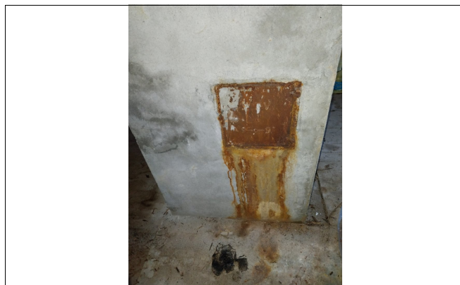
Pipe 1; ny feieluke må monteres
