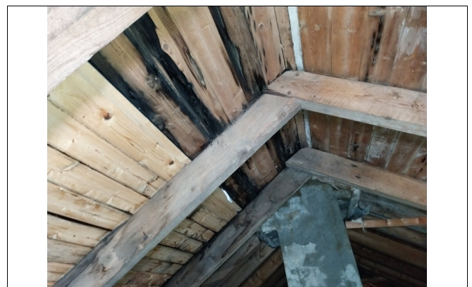
Kaldloft; mørke flekker i taktrobord og sperrer.
