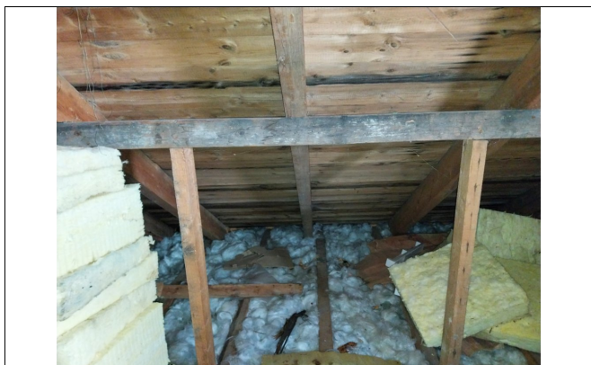
Kaldloft; mørke flekker i taktrobord
