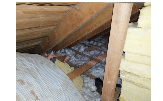
Kaldloft. Glassvatt som isolasjon mellom undeergurtene
