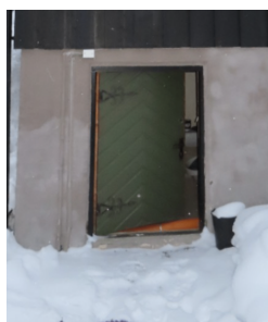
Parti av mur under dør inn til blindkjeller som svakere og med sprekkdannelser i overgang.
