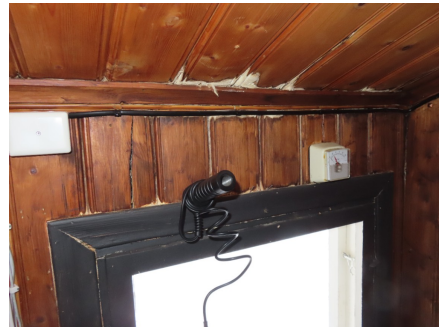
Vindu på kjøkken. Søkepinner for fuktsøk kunne skyves gjennom konstruksjonen = massiv råteskade
