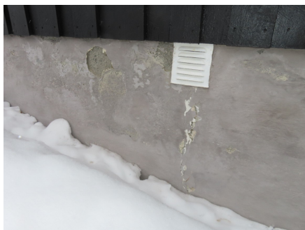
Sprekkdannelse pga setninger og avskalling pga fukt og frost.
