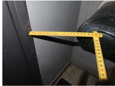
Ovnsrør fra vedovn er etablert for nærme brennbart materiale.
