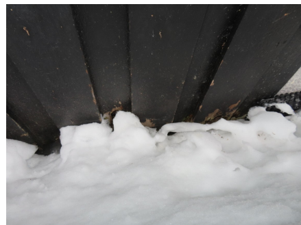
Påvist fuktskader i ytterveggskledningen - råteskadene strekker seg inn i konstruksjonen. Merk også at det med verveidende sannsynlighet er skader i innenforliggende trebjelkelag.
