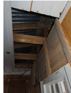
Adkomst for besiktigelse av del av takkonstruksjonen - den del som er tilgjengelig for inspeksjon over vindfang, overbygd inngangsparti og bod.
