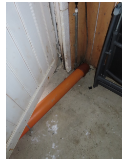
Støpt gulv. Innforet vegg. Merk påvist fukt i nedre del av treverk.
