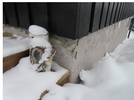
Partier med avskalling av murens overflate pga fuktopptrekk og frostsprengninger i muren.
