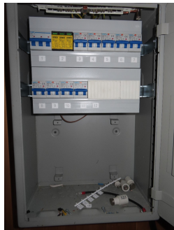
Nye jordfeilautomater med 3 faset hovedsikring (3x16 amp).
