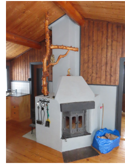
Murt gruepeis i stue med senere etterinstallasjon av støpejernsinnsats/innsatskassett.
