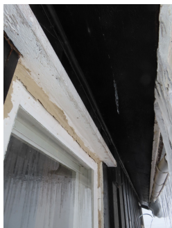
Det ses former for reparasjonstiltak utv. på og rundt vindu pga fuktskader.
