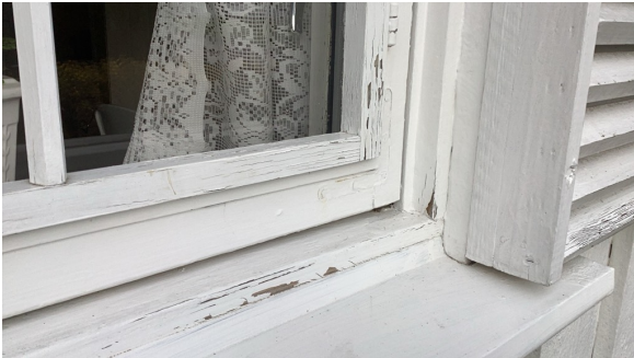
Eksempel på slitasje.
