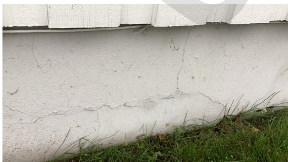
Eksempel på svinnsprekker.
