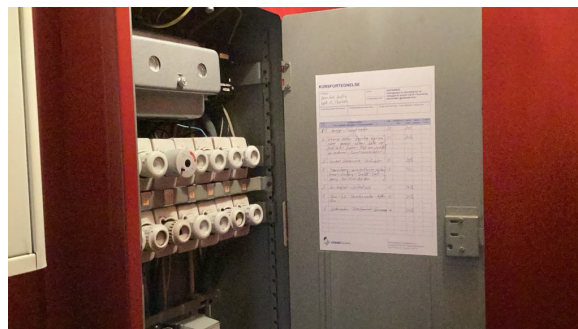
Sikringskap med hovedsakelig porselenssikringer.
