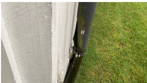
Skade på taknedløp.
