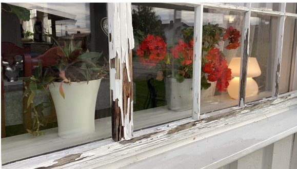
Råte på sprosse.
