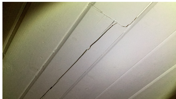
Eksempel på sprekk i panel i himling.
