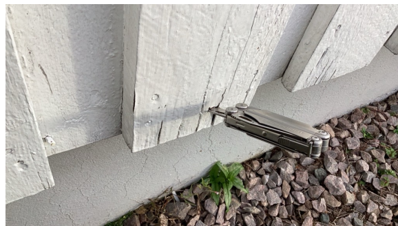
Eksempel på råte i kledning.
