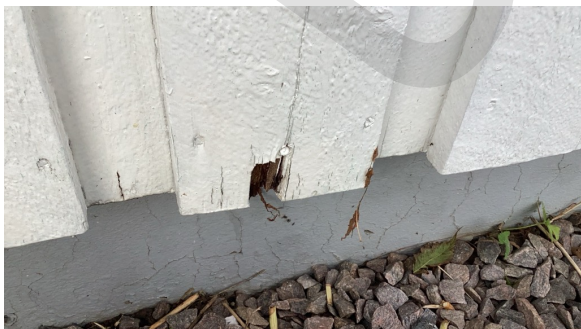
Eksempel på råte i kledning.
