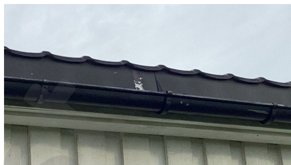
Eksempel på avskaling på beslag
