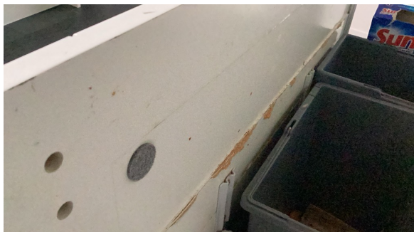
Eksempel på slitasje.
