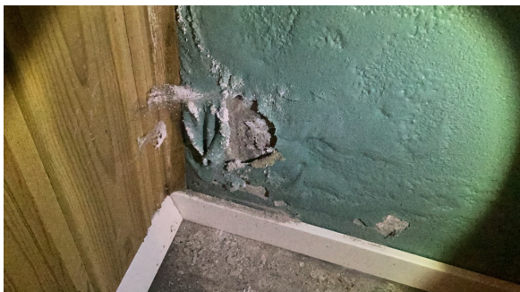
Eksempel på avskaling og saltutslag.
