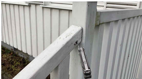
Begynnende råte i rekkverk på trapp.
