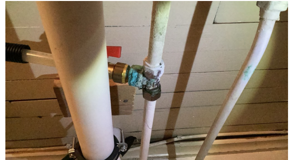
Stedvis korrosjon på skjøter.
