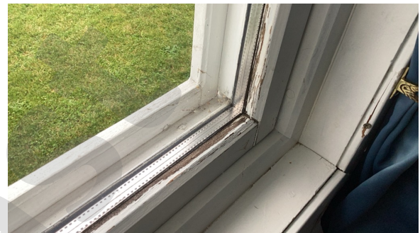
Eksempel på innvendig slitasje.
