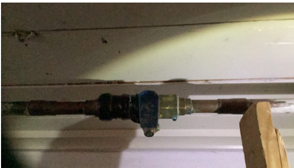
Det drypper fra rørskøt.
