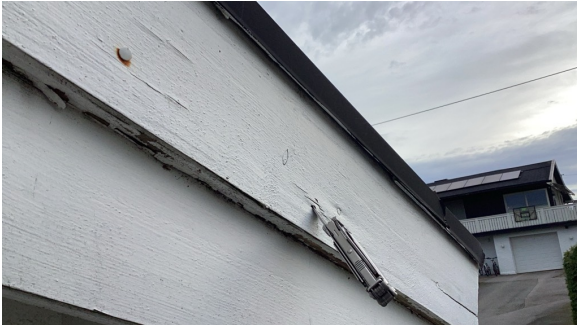
Råte i vindski.
