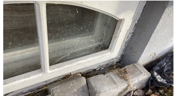
Sprekk i glass på kjellervindu.
