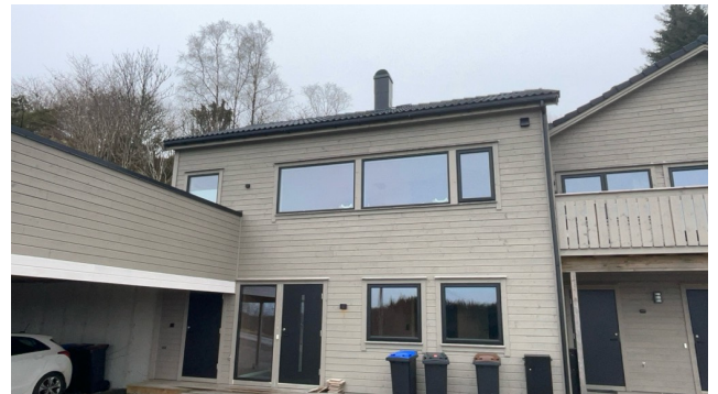
Ikke montert snøfangere
