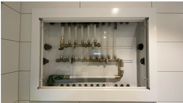
Rørskap med stoppekran.
