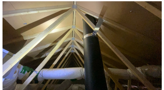
Stålpipe på kaldtloft.
