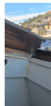
Fukt merker svarte sopp utvendig karm
