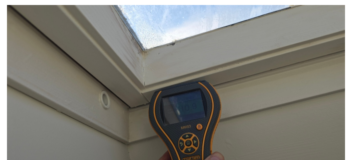
fukt merker innvendig karm
