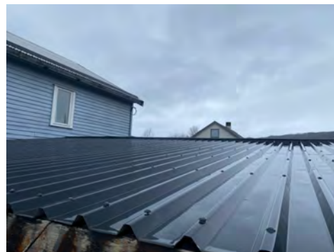
Tak over bod, manglende snøfangere.
