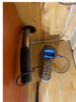
Fuktmåling i skillevegg mot bad.
