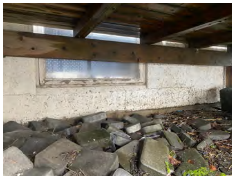
Vindu til bad i kjelleretasje.
