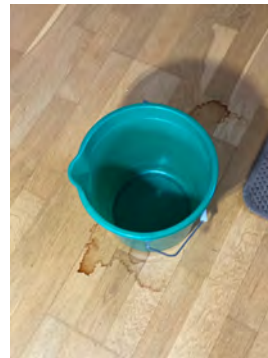
Lekkasje fra taket mellom stue/kjøkkenet.
