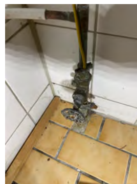
Vannlås med usikker funksjon.
