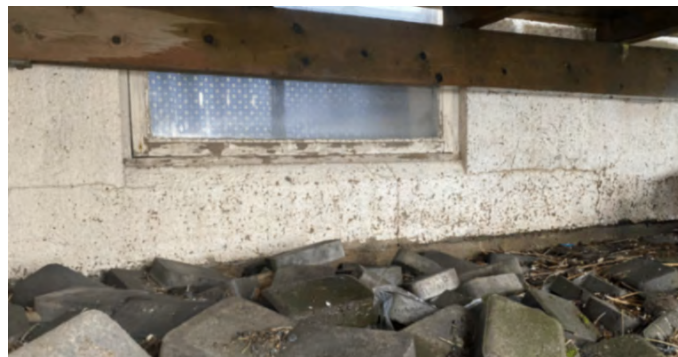
Riss i mur.
