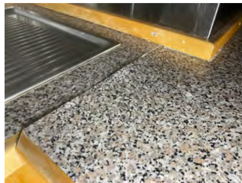
Svelling i benkeplate.
