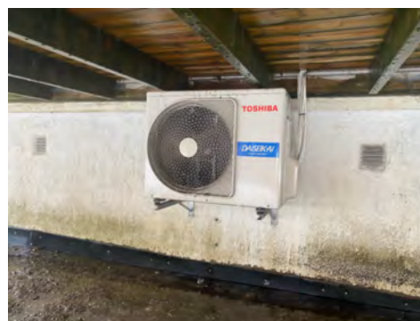
Varmepumpe utvendig del.
