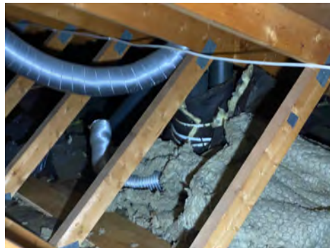
Fuktskjolder på underside av undertak.
