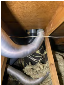
Feil ved gjennomføring i undertak. Åpen konstruksjon.
