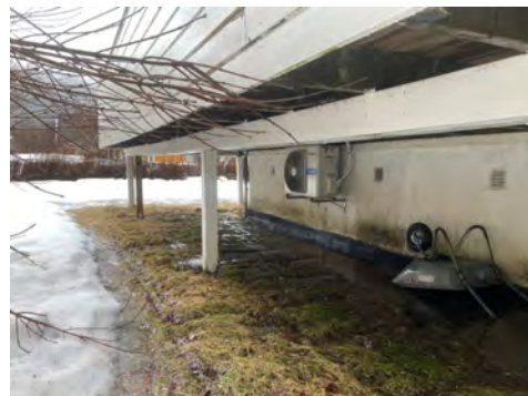
Skjevheter i konstruksjonen.
