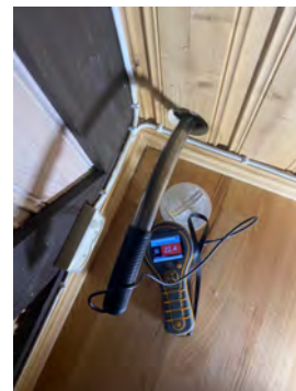
Fuktmåling i vegg i kjellerstue med forhøyde verdier.
