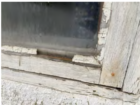
Skade i kitt på kjellervindu.
