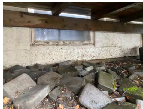
Ingen synlig fuktsikring mot mur.
