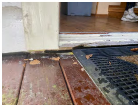
Mangler beslag og fuktskade i terskel.
