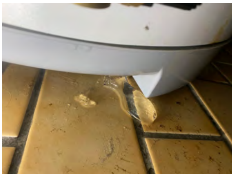
Tegn til lekkasje.
