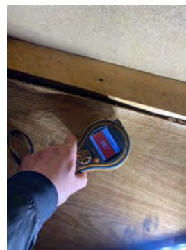
Fuktutslag på gulvbelegg i kjellerbod.
