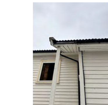
Mangler takrenne ved garasje.
