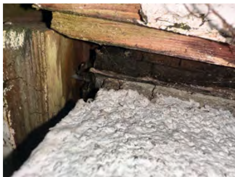
Ingen musestopper, lite lufting vbak kledning.
