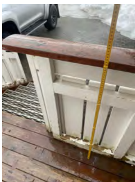
Slitt ballongdekket og rekkverk.
