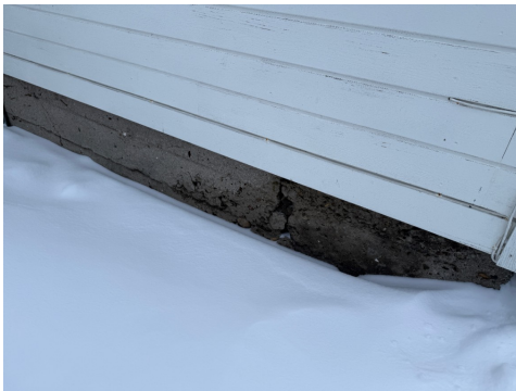
Synlige sprekker i grunnmur
