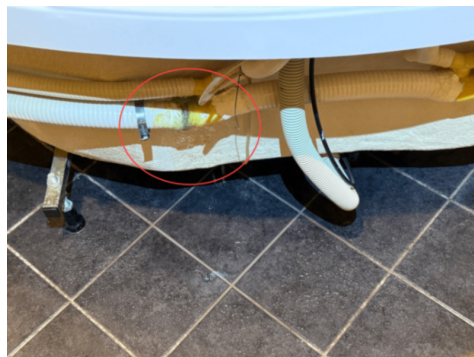
Aktiv lekkasje fra badekarets røropplegg
