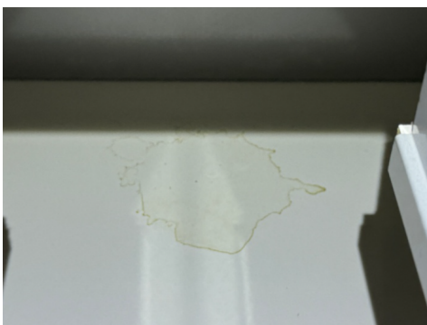
Fuktmerke i innredningen under servanten
