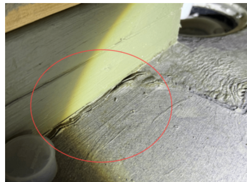
Oppsprukket membran mellom gulv og vegg
