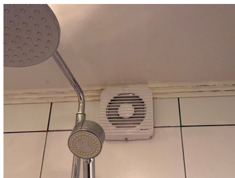
Avtrekksvifte i dusjen
