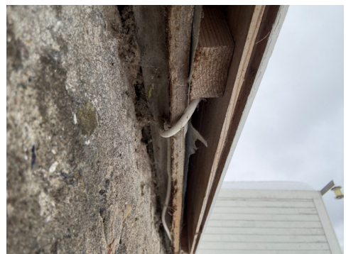
Mangler musesperre i nederkant av kledningsbord mot grunnmur på hoveddel
