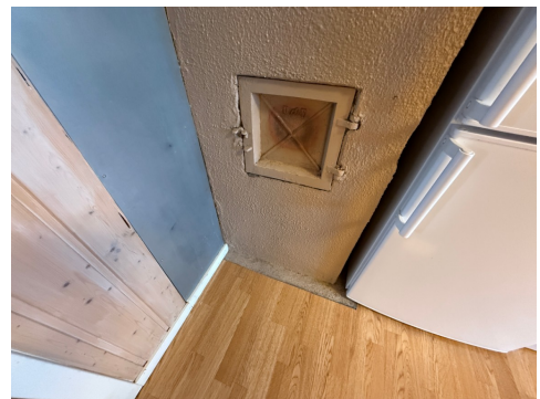
Sotluke på kjøkkenet
