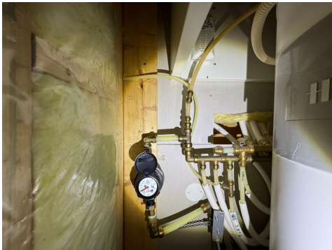
Røropplegg bak varmtvannstank/under trappen
