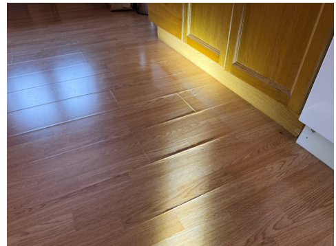
Svellinger i gulvoverflate
