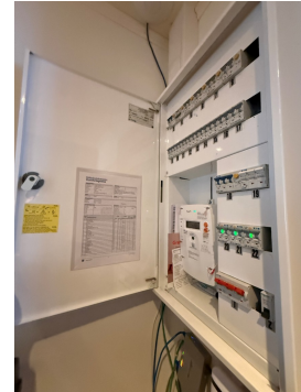
Sikringsskap i gang tilleggende bad på loftet
