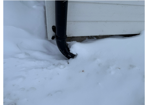
Utilstrekkelig bortledning av takvann
