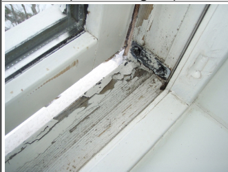
Vinduer kan trenge noe vedlikehold
