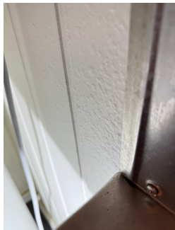
Svelling i overflaten på veggplater ved vaskekar.
