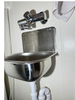
Svelling i veggplater i området rundt vaskekar.
