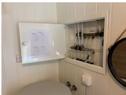
Oversikt rør i rør skap
