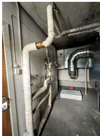
Vannbåren varmebatteri med tilførsel fra varmesentral i kjeller.
