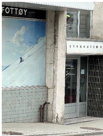
Rør for påfylling og lufting til nedgravd oljetank.
