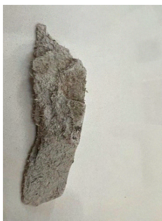
Bruddstykke fra himlingsplate i kjeller, sannsynligvis med asbestinnhold
