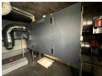
Ventilasjonsaggregat i 5. etasje.
