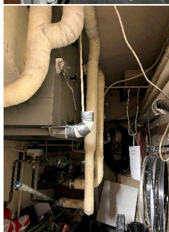
Befuktingsanlegg i kjeller (ikke i bruk)
