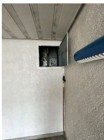
Inspeksjonsluke til vertikal teknisk sjakt.
