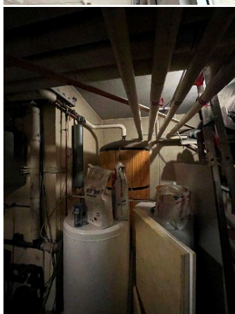
Isolerte rør i varmesentral
