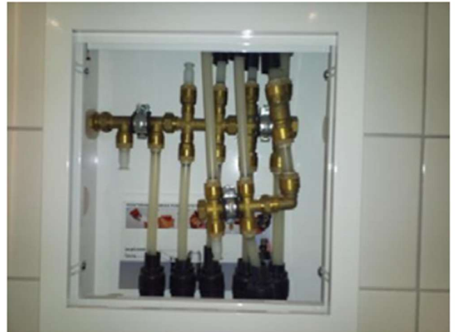
Bad - [Fordelerskap for rør-i-rør system.]
