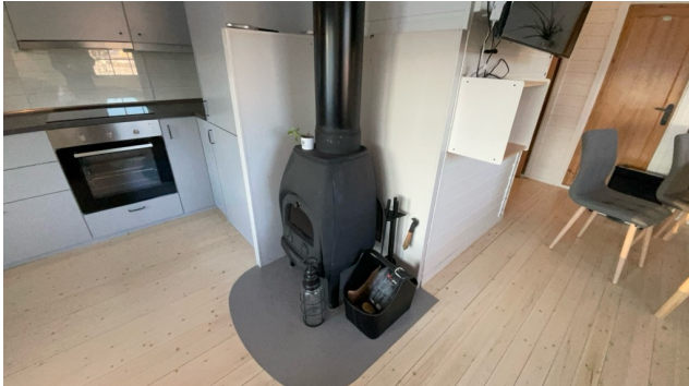
Vedovn i stue med topp montert pipe.
