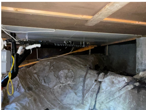
Del av rør er isolert.
