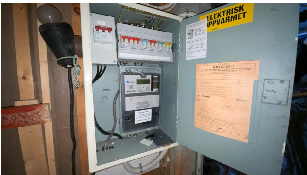
Sikringsskap i krypekjeller.
