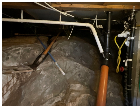
Avløpsrør i kryperom.
