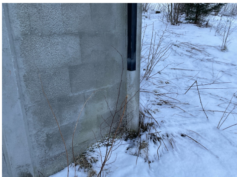
Rør mot nord uten tilkobling til rør i bakken.
