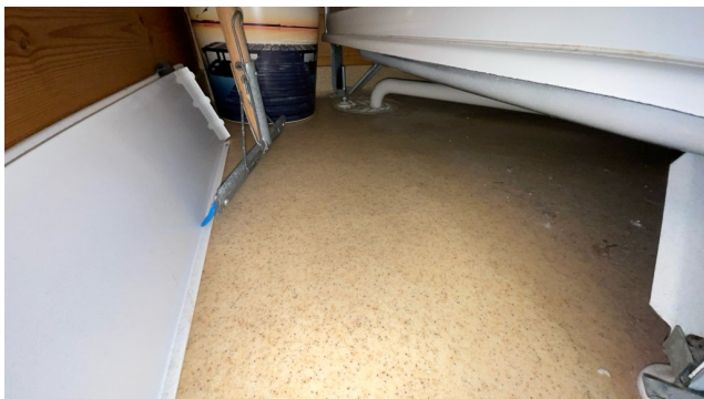
Sluk under dusjkabinett.
