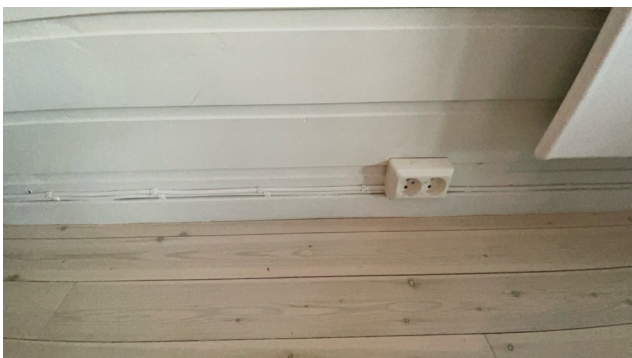
Åpen installasjon i opprinnelig del av hytta, skjult installasjon i tilbygg.
