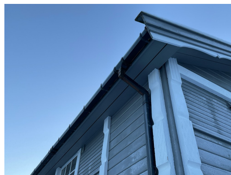
Firkant renne og nedløp.
