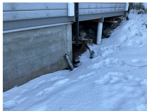
Nedløp frakoblet fra rør i bakken.
