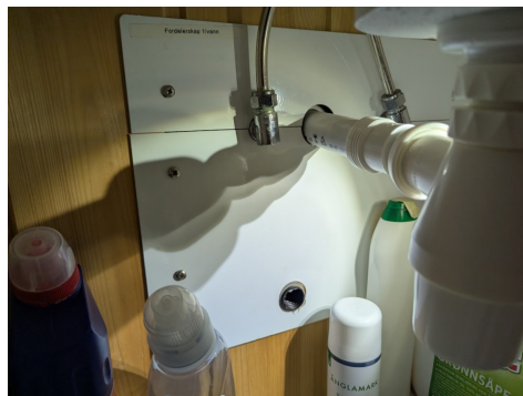
Fordelerskap for vannrør på bad
