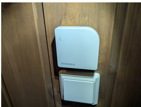
Styring og termostat for gulvvarme
