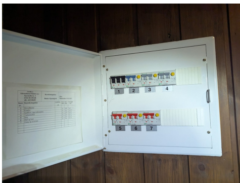
Innmat i sikringskap
