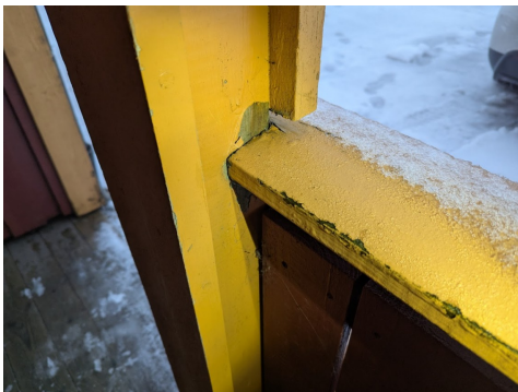
Rekkverk med vedlikeholdsmangler
