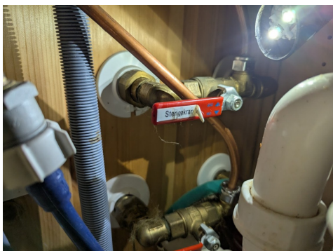
Vannrør i kjøkenskap
