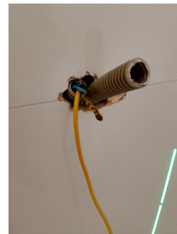
Løs ledning og usikret hull i badevegg.
