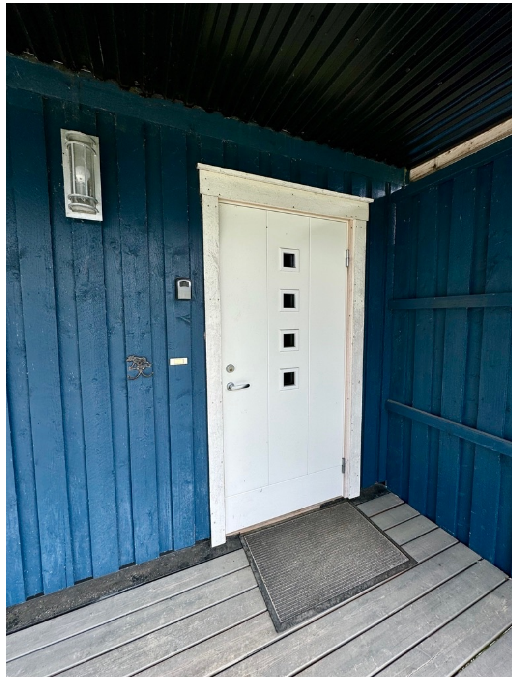
Kodeboks ved inngangsdør
