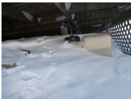
Parafintank under terrasse.
