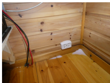
Snø inne på gulv i stue
