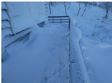
Rekkverk er ustabil og har skjevheter
