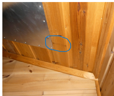
Litt fuktskjolder i gjennomføring i stue
