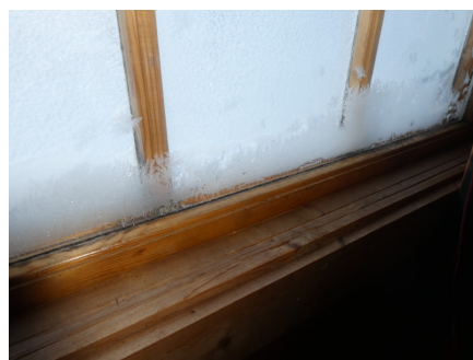
Snø mellom glassene på vindu i stue
