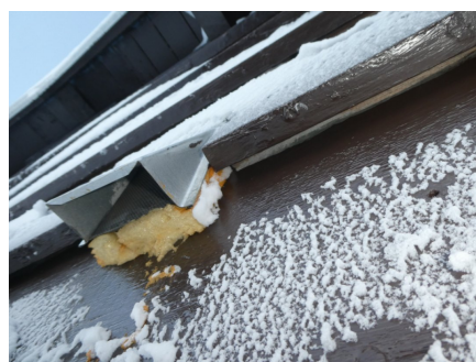
Noe uheldig løsning
