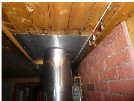
Fuktskjolder i gjennomføring i kjøkken
