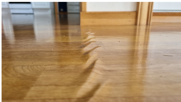
Belegget i stuen er stedvis ikke tilfredsstillende festet til underlaget.
