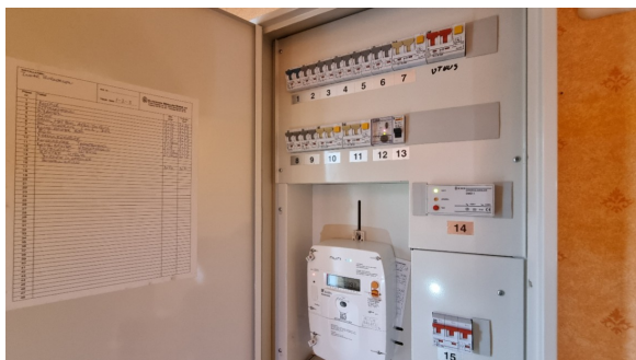
Kontroll av el-skapet
