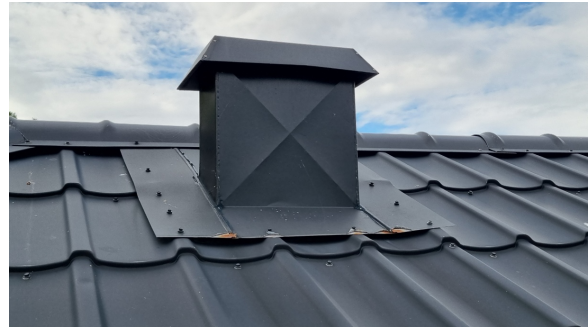
Kontroll av luftehatt.
