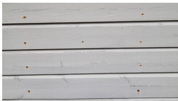
Kledningen har stedvis spiker med rust på spikerhode.
