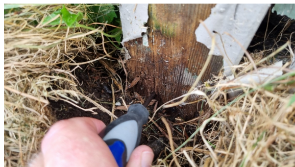
Svekkelser i søyler som er ført ned i bakken.
