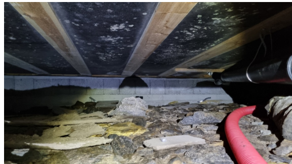
Tegn til fuktskader i krypkjeller.
