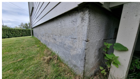
Utvendig grunnmurer er påført et tynt lag med puss.
