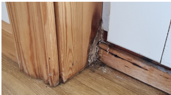
Synlig fuktinntregning ved skyvedøren i stuen.
