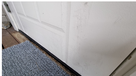
Hovedinngangsdøren er utvendig værslitt.
