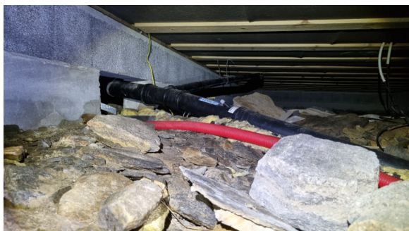
Liten åpning inn under baderommet.
