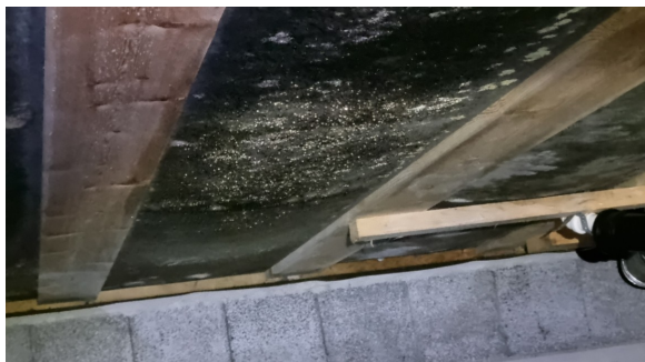
Krypkjeller under baderommet. Her sees soppvekst i stubbloftet. Deler av bunnsvillen her er mørkere i farge, dette skyldes trolig fukt
