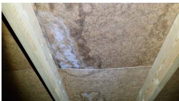
Stedvis fuktmerker og soppevekst i takkonstruksjonen på kaldloftet.
