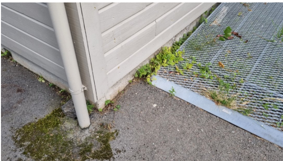
Takvannet blir ikke ledet bort fra bygningskroppen.
