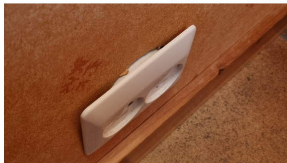
Kontakt på toalettrommet er ikke tilfredsstillende festet.
