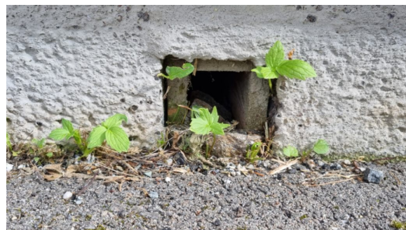
Åpning i grunnmur uten sikring.
