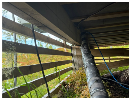
Drager er ikke skjøtet over pilar.
