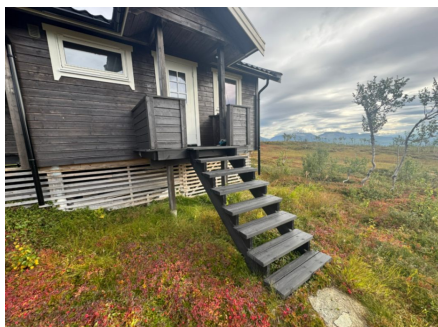
Det er ikke montert rekkverk i trappen.
