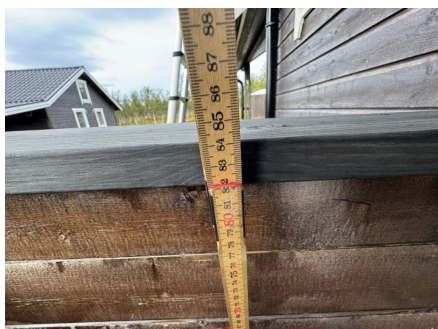
Rekkverkshøyden ved trappen.
