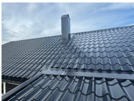
Det er ikke montert takstige.
