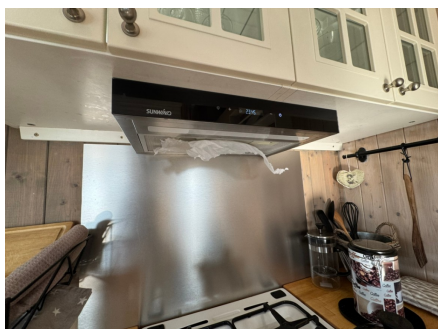
Funksjonstest av ventilatoren.
