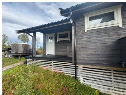
Det er ikke montert rekkverk ved platten.
