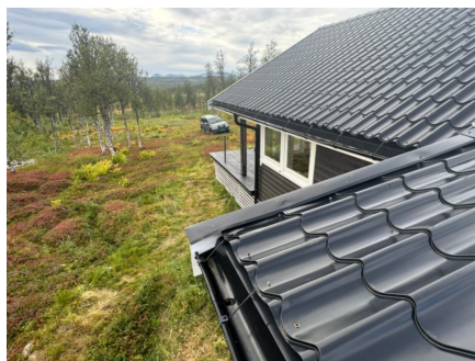
Det er ikke montert snøfangere hvor folk kan ferdes.
