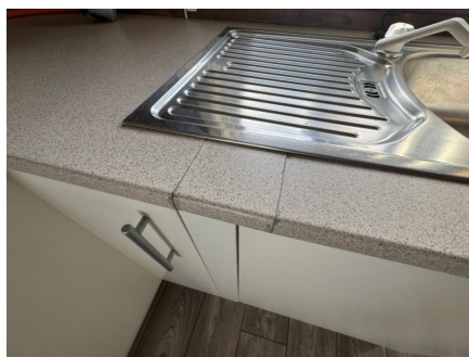
Ufagmessig utførelse av benkeplate.
