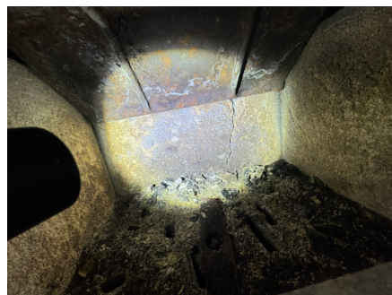
Sprekk i ildfast stein.
