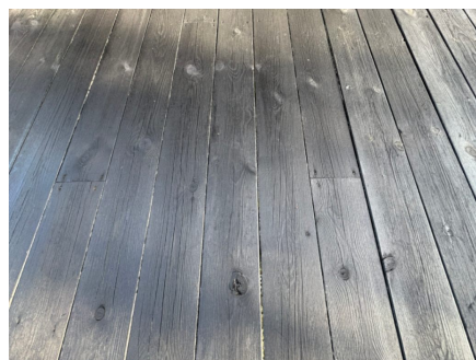
Eksempel på terrassebord som ikke er tilstrekkelig skrudd fast.
