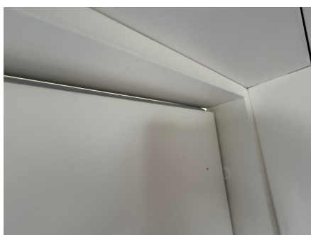
Utett mellom dør og karm.
