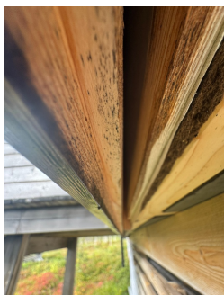
Det er ikke montert musesperre i nedkanten av kledningen.
