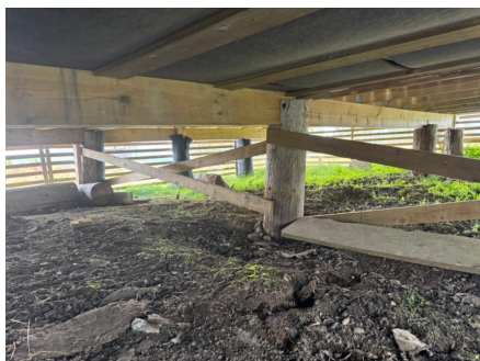
Eksempel på skjeve pilarer.
