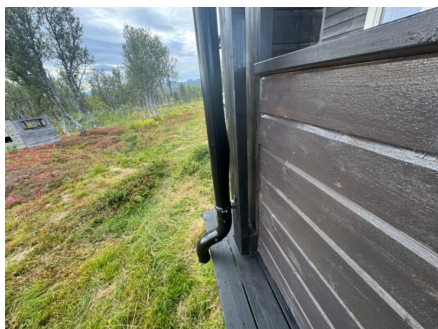
Takrennenedløp er skadet.
