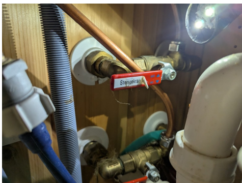
Vannrør i kjøpenskap
