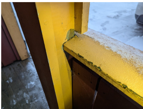
Rekkverk med vedlikeholdsmangler
