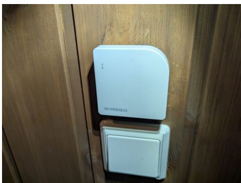
Styring og termostat for gulvvarme
