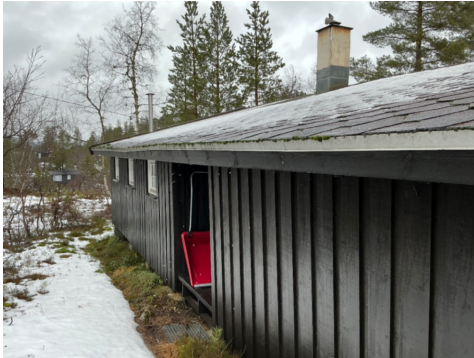
Synlig skjevhet utvendig.
