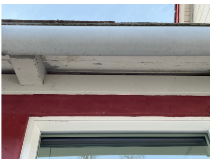
Luftespalte ved raft.
