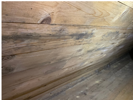
Mindre tegn til svertesopp inne i kott.
