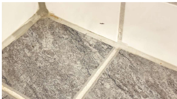
Glippe mellom flis og elastisk fuge.
