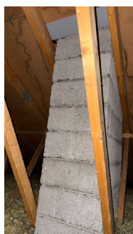
Fuktmerker i undertak ved skorstein.
