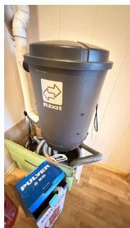
Støvsugermotor i innvendig bod.
