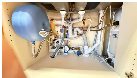
Vanninntak i oppvaskbenk.
