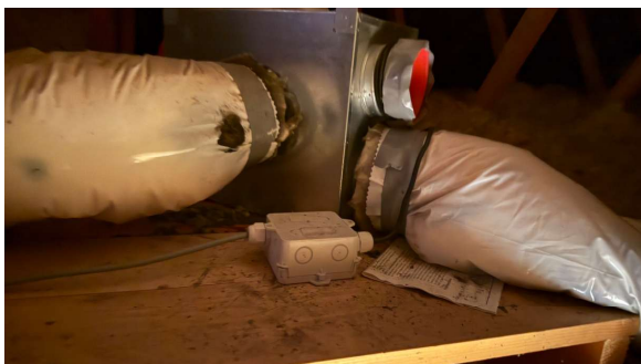
Avtrekksvifte på loft.
