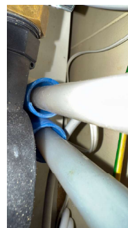
Manglende tettemuffer på vannledninger i oppvaskbenk.
