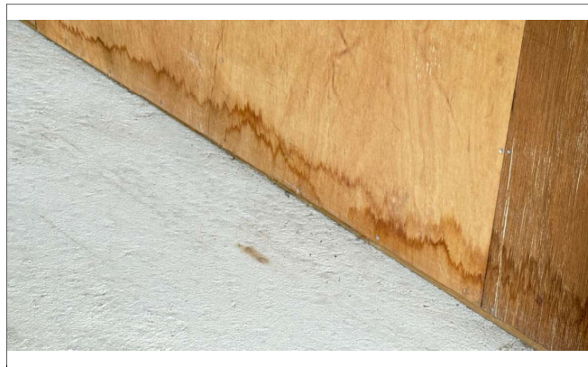
Bilde nr. 2 Fuktoppsug i veggplater.
