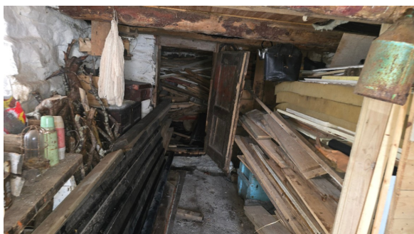
Mye lagrede gjenstander begrenset inspeksjonen.
