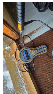
Fuktighet, noe råte og borebiller i gulv/terskel.
