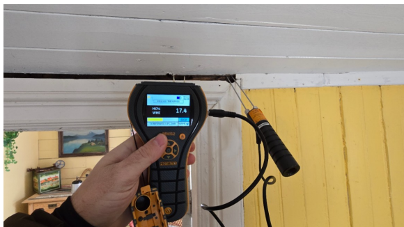
Fuktig sperr og råte i konstruksjonen ved dør.
