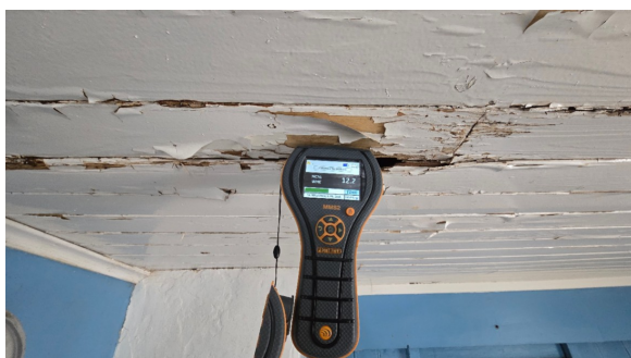
Følgeskader ved pipe etter løekasjer, tørr panel på befaring, men mulig skjulte skader.
