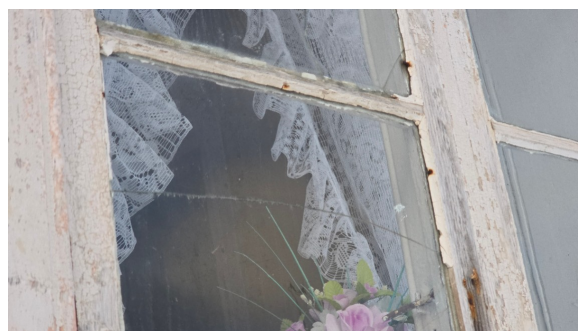
Sprekker i enkelte glass.
