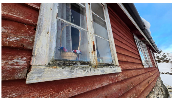
Råteskader på vindu.
