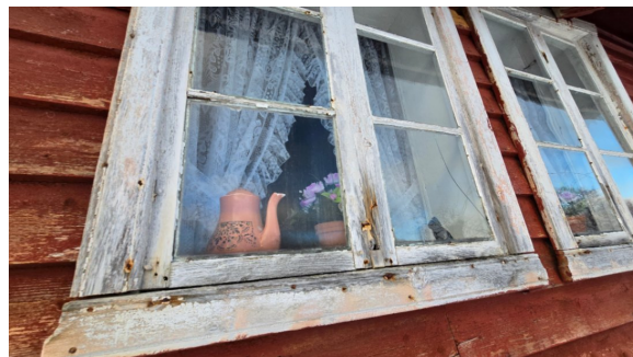
Råteskader på vindu.
