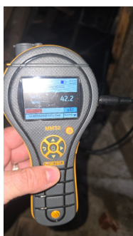
Trevirke mot gulv i underetasjen er våt, råtedannelse
