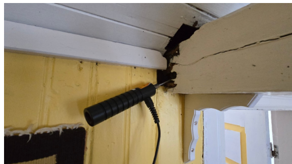
Råte i bjelke
