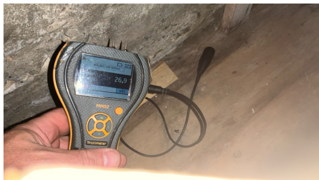
påvist fukt i golv
