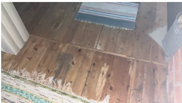
innvendige flater er noe slitte
