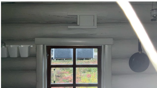
ventil i vegg
