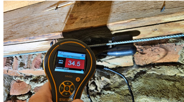
Fuktmåling ved pipe.
