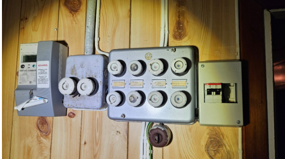
Kontroll av el-tavle.
