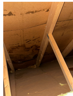
Fukt/kondensmerker mot raft som er har begrenset lufting.
