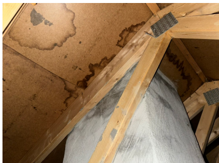
Fuktmerker rundt pipeløp.
