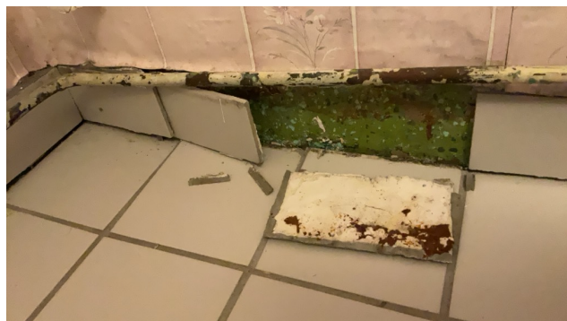
Eksempel på skade.
