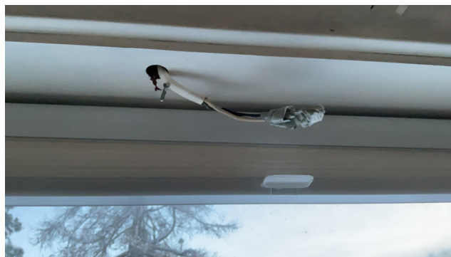
Løs elektrisk installasjon i stuevinduer.
