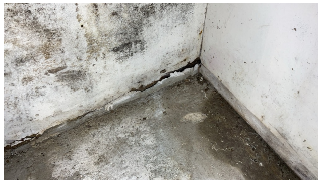
Eksempel på fuktinntrengning og muggdannelse.
