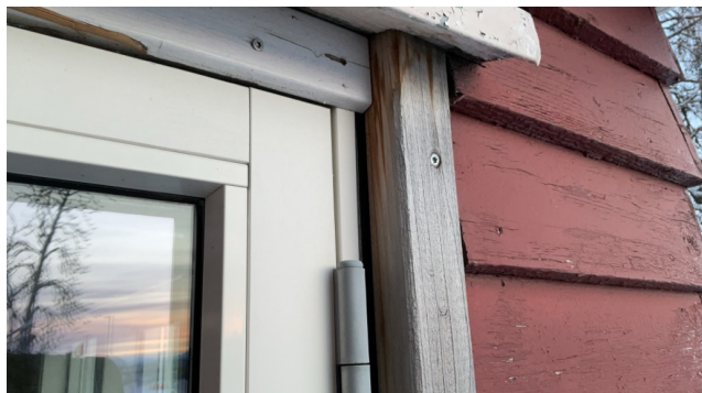
Eksempel på ufagmessig utførelse av omramming på balkongdør.
