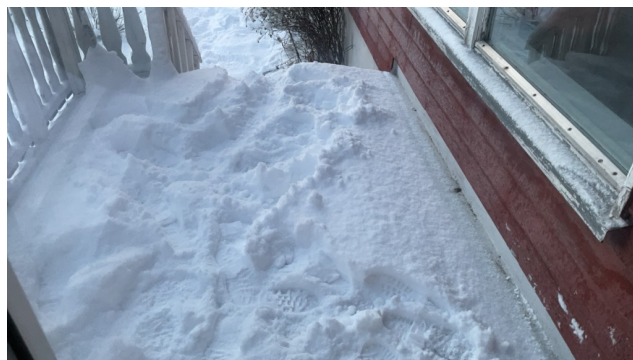
Balkong er snødekket noe som medfører begrenset mulighet for inspeksjon som naturlig forutsatt.
