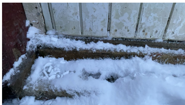
Eksempel på manglende beslagsutførelse under kjellerdør.
