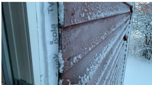
Eksempel på manglende ferdigstilling av utvendig tetting rundt vindu.
