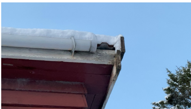
Eksempel på manglende takrenne.
