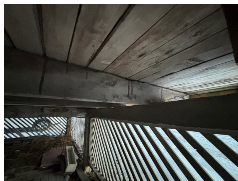
Eksempel på fuktskjolder og råteskade.
