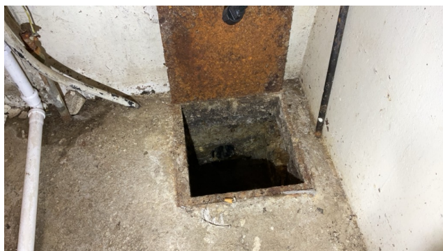
Utett plasstøpt stakekum på bunnledning.
