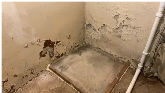
Eksempel på saltutslag.
