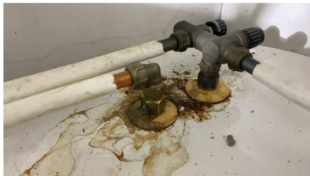
Eksempel på rust.
