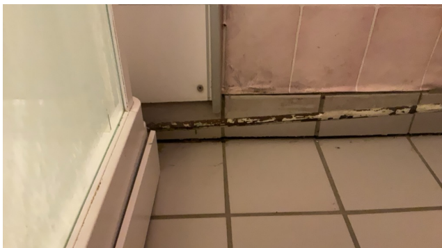
Eksempel på skade.
