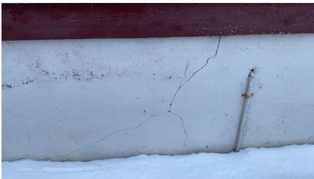
Eksempel på riss og sprekker.
