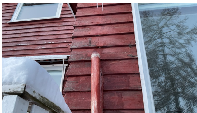
Eksempel på værslitt bordkledning.
