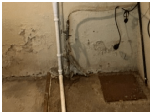
Eksempel på manglende klamring.
