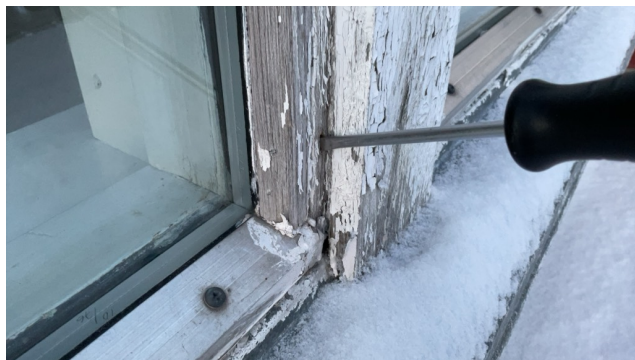
Eksempel på råteskade og værslitt treverk.
