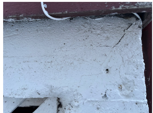
Eksempel på riss og sprekker.
