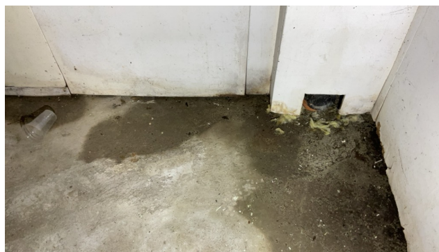
Eksempel på fuktinntrengning.
