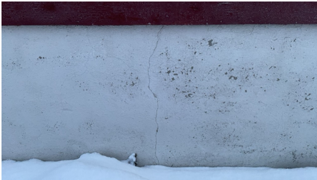
Eksempel på riss og sprekker.
