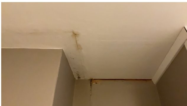
Eksempel på skade/fuktskjolder ved pipe.
