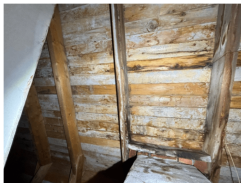
Eksempel på fuktskjolder og råteskader i takkonstruksjonen ved pipegjennomføringen.
