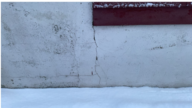
Eksempel på riss og sprekker.
