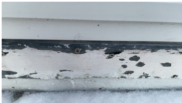
Ikke fagmessig utførelse av beslagstetting under balkongdør.
