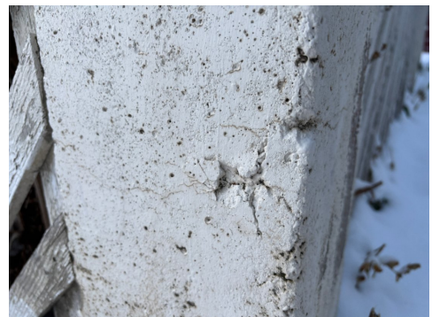
Eksempel på riss og sprekker.
