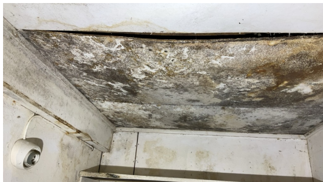
Fuktskader i kjellerhimling under sluk fra bad/vaskerom.
