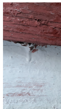
Eksempel på utetthet i glassfibertekking.
