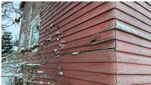
Eksempel på råteskade på bordkledning.
