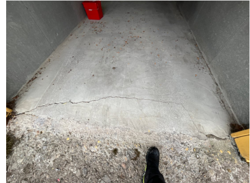
Sprekk i støpt gulv i garasjen
