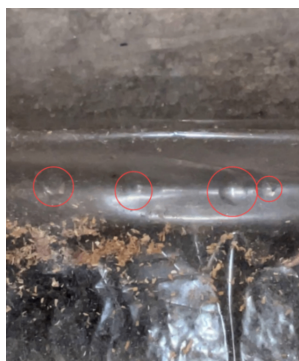
Synlige vanndråper i innforet vegg
