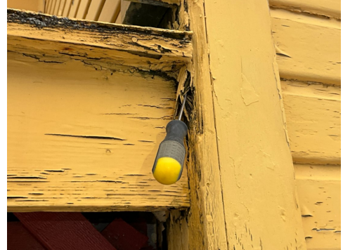
Råteskader i kledningsbord ved terrassen
