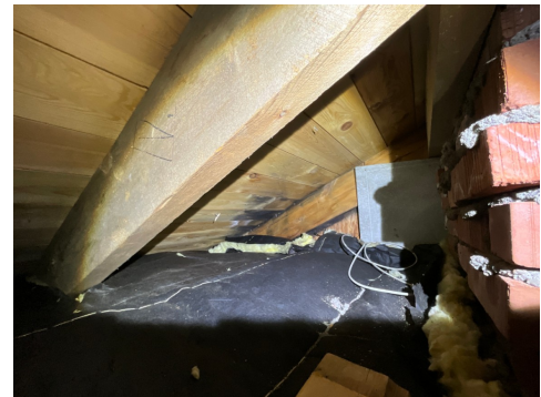
Misfarginger i undertak ved pipen
