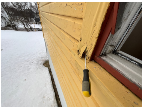
Råteskade i vindusomramming
