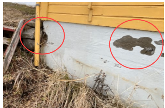
Skade i grunnmur og løs og avflasket maling/puss
