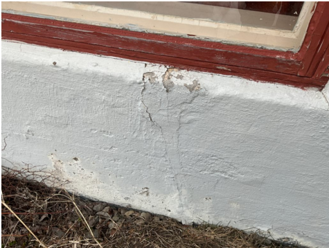
Sprekker i utvendig puss på grunnmur
