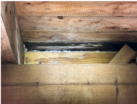
Vått konstruksjonsvirke under terrassen
