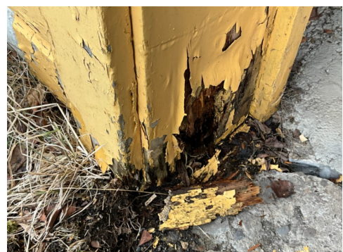
Råteskadet kledning ved garasjen
