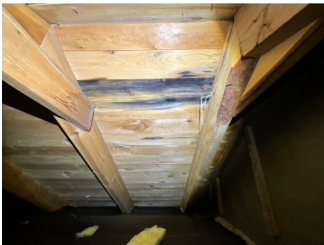
Misfarginger i undertak over tilbygg
