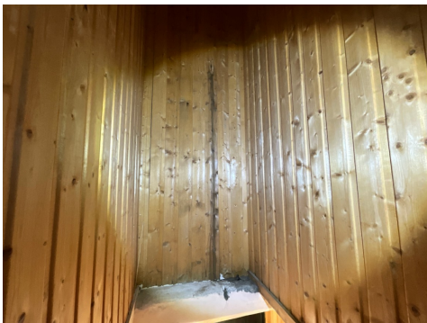
Fuktskjolder på veggpanel
