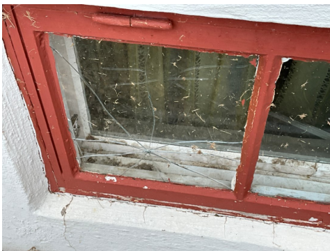
Vindu med sprukket glass
