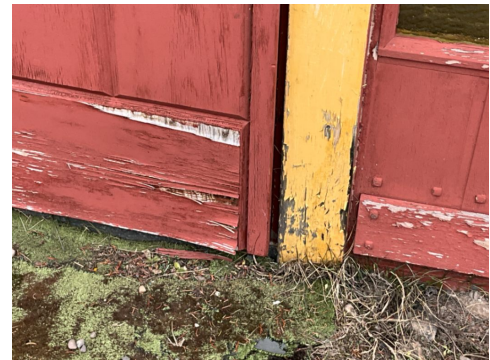
Avvik i tterdør i underetasje
