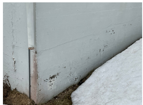
Manglende bortledning av takvann fra nedløp
