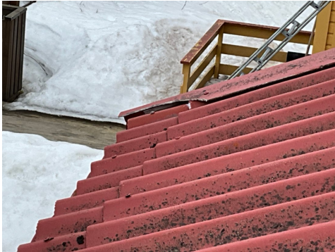
Skade i vannbord
