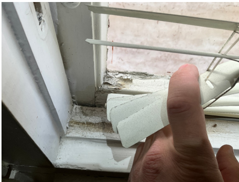
Vinduer med tegn på kondenseringer på innvendig glass
