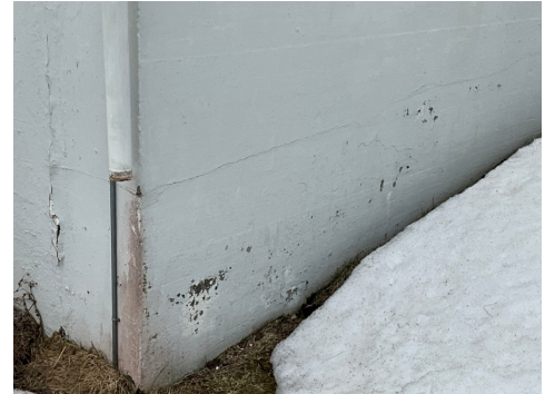
Sprekker i utvendig puss på grunnmur
