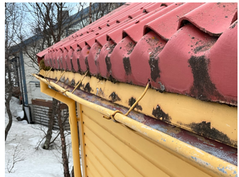
Bøyde takrenner og rust i innfestinger
