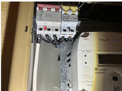
Synlige strømledende deler i skapet
