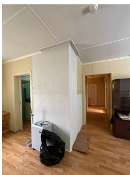
Pipe i stue i original del ikke tilknyttet ildsted
