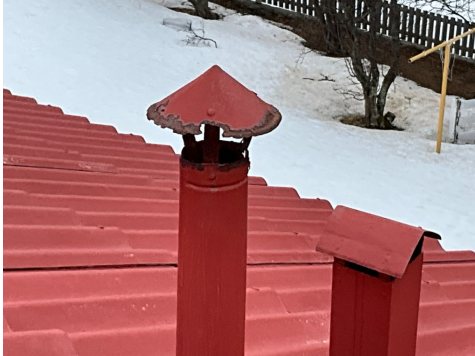
Rustskader på luftelyre
