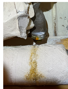
Tegn på mindre lekkasje fra kobling i himling i underetasjen
