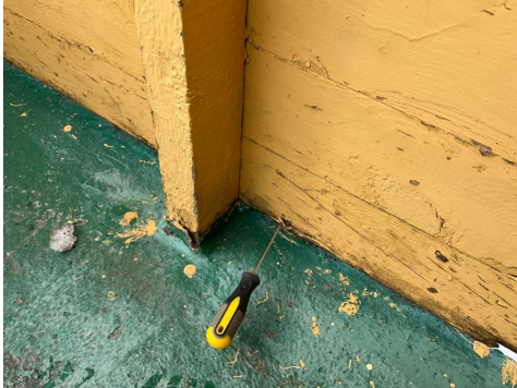
Råte i kleddningsbord på rekkverket
