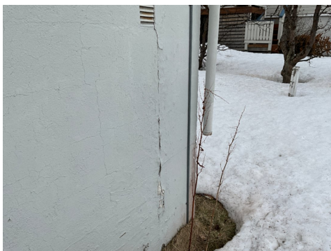
Sprekker i utvendig puss på grunnmur
