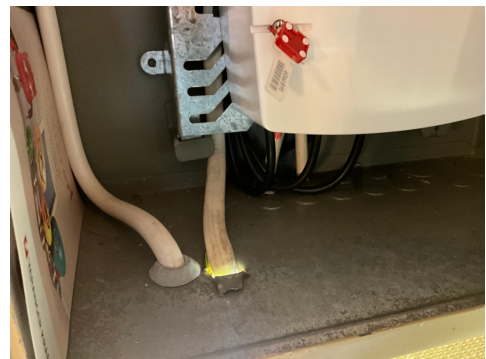
Åpent hull i sikringsskapet
