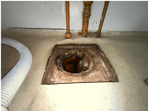
Utett overgang mellom gulv og sluk
