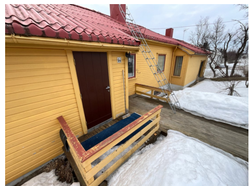
Mangler snøfangere/rassikring over inngangsparti
