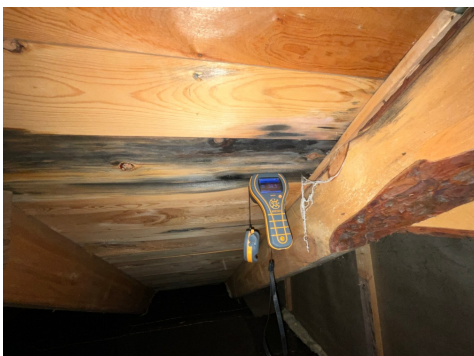
Fuktmåling i undertak over tilbygg
