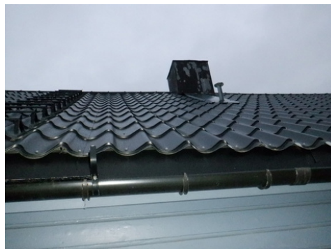
Pipebeslag har avskalling.
