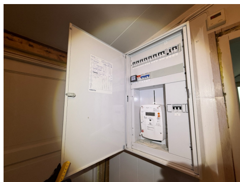
Sikringsskap på loftet
