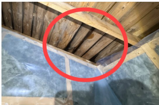
Synlig fukt i taket
