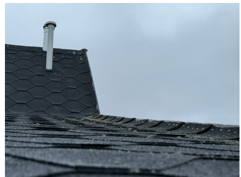
Synlige spikre og mangler vannbord
