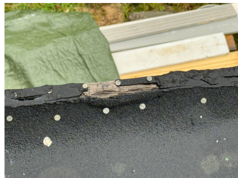
Synlige pappspikre og treverk
