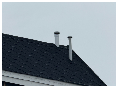
Synlige spikre rundt rørgjennomføringer
