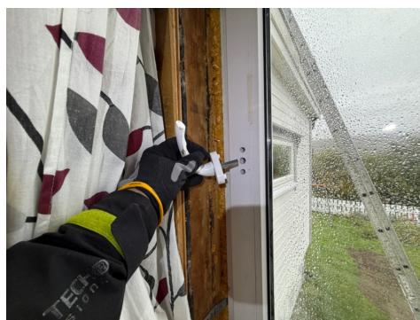
Løst håndtak på kjøkkenvinduet
