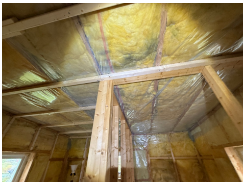
Misfarginger i isolasjonen i himlingen
