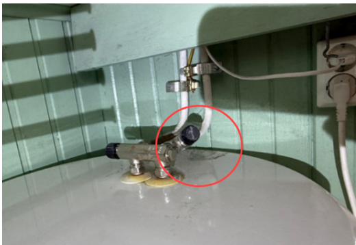
Merker på varmtvannstanken under vannrør
