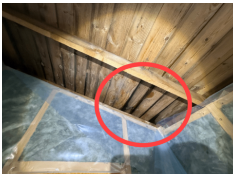
Synlig fukt i undertaket
