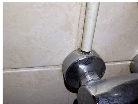
Sprekker i fliser på vegg
