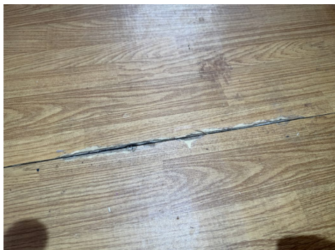
Sprekk i gulvbelegg i stue
