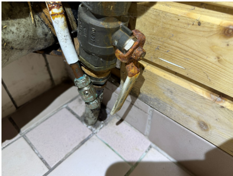
Hovedinntak og stoppekran
