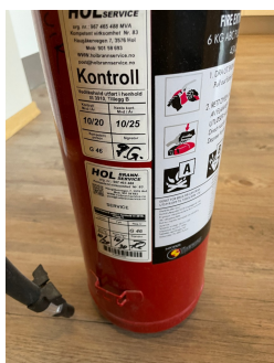
Pulver brannslukningsapparat. Neste kontroll okt/2025
