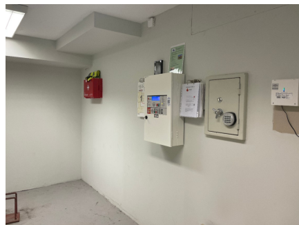
Felles brannsentral plassert i kjelleretasje.
