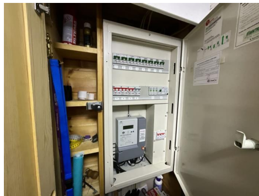
Sikringsskapet er plassert i skap i gang.
