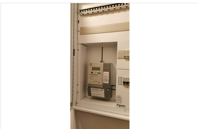
Sikringsskap med automatsikringer begge etasjer
