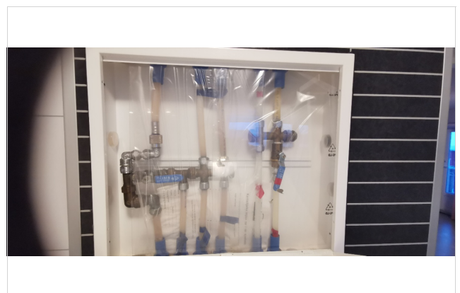
Samleskap rør-i-rør på bad i begge etasjer.
