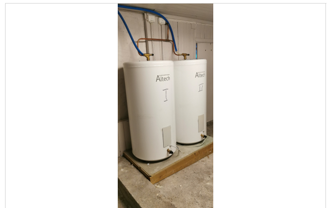
200 l VVB plassert på bod i kjelleren.
