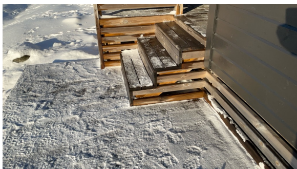
Trapp uten rekkverk.
