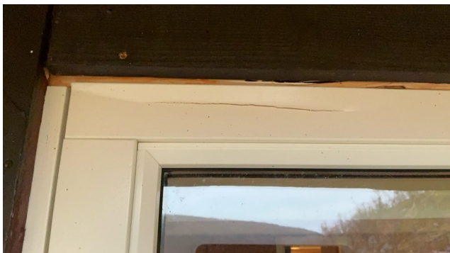
Skade på terrasse dør
