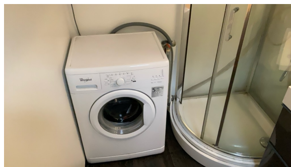
Opplegg til vaskemaskin på bad.
