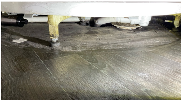
Sluk under dusjkabinett.
