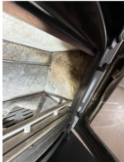
Sprekk i stein innvending i ildstedet
