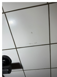
Sprukket flis og skruenhull i vegg i våtsonen
