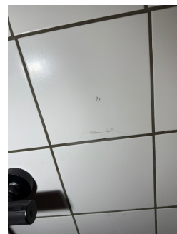
Sprekker i flis og skruehull i våtsonen
