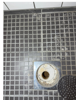
Ujevn fuger på fliser i dusjsonen
