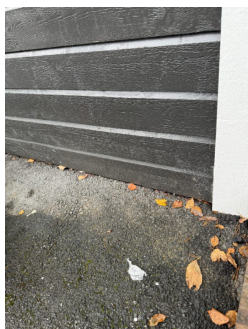
Bordkledning ligger tett på terreng
