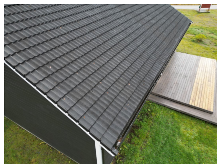
Manglende snøfangere ved terrasse.
