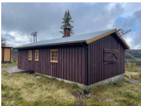
Dårlig terrengfall vekk fra bygget på sørsiden av hytta
