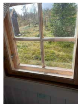
Tegn på innvendig kondensering
