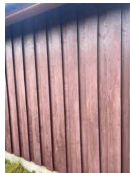
Værslitt / oppsprukket trekledning
