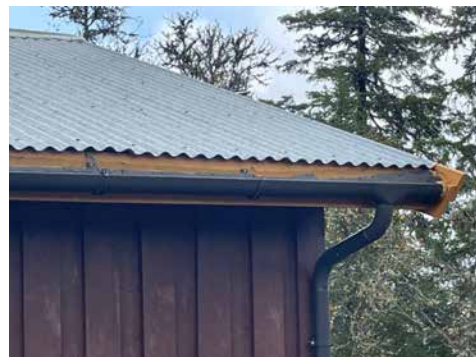
Løs papp i overgang takrenne
