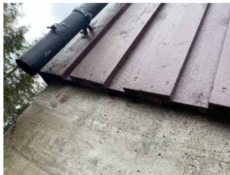
Manglende lufting bak kledning
