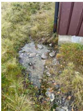
Stående vann på eiendommen grunnet dårlig drenering ved taknedløp
