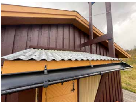
Mangelfull lufting i gavl.
