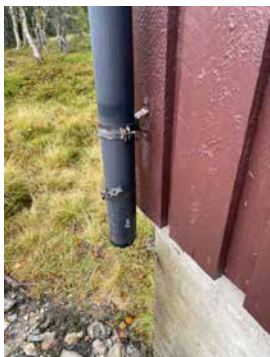
Manglende kontrollert bortledning av takvann
