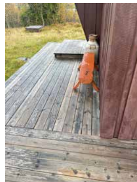
Værslitte overflater på terrassebord.
