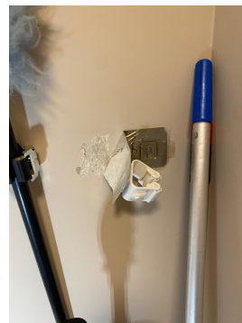
Skade overflate vegg, toalettrom.
