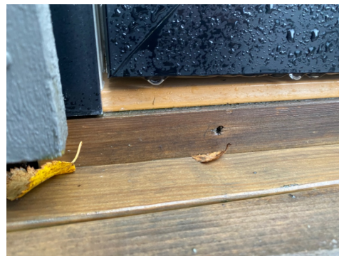
Manglende beslag i nedkant.
