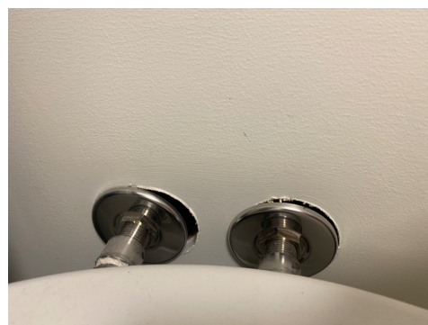
Rørgjennomføring mot vegg fra VVS bereder på boden.
