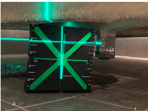
Måling av fall til sluk.
