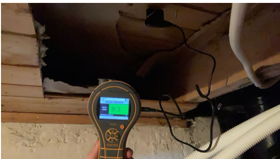
Fuktmåling i treverk under bad/vaskerom.
