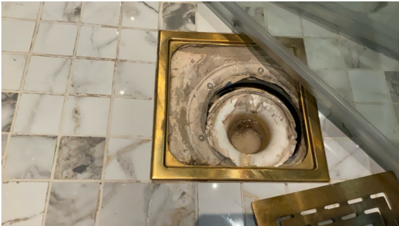
Sluk i dusjsone.
