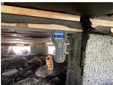
Dragere mitt i hytten er høy fuktighet. store skjevheter i konstruksjonen.
