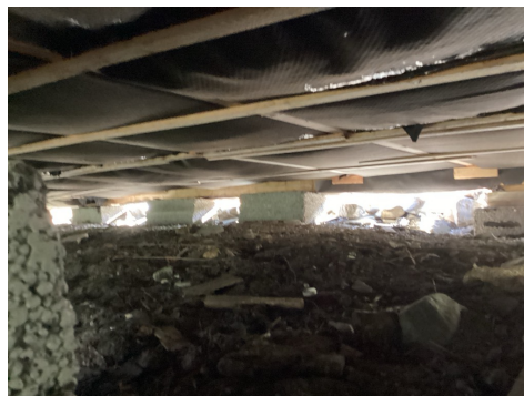
Lav høyde fra terrenget til bjelkelag. Mye revet papp og gjennomføringer er åpen. anbefaler nærmere undersøkelser på skade dyr.
