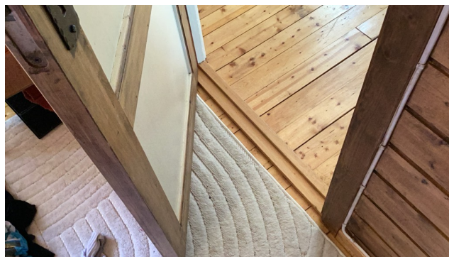
Mangler tilluft til soverom og toalett rom.
