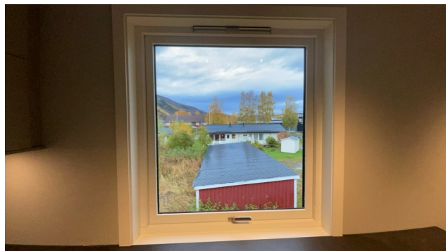
Vindu ved kjøkkeninnredning.
