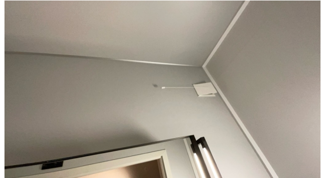
Ventilasjon på bad.
