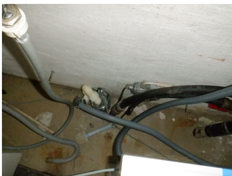
Avløp fra vaskemaskin
