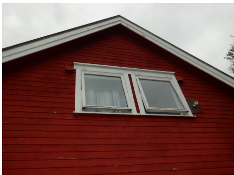
Vinduer med råteskader.
