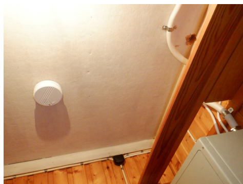
Ledninger fra byggeår, mulig kuleledning
