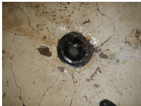
Plastsluk med rustne skruer.
