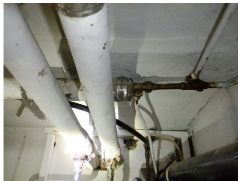
Lekkasje på vannledning
