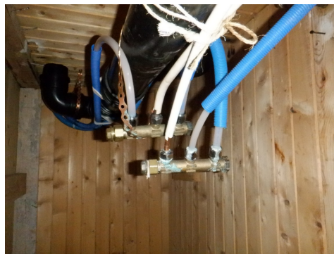
Rør i rørsystem uten rørskap
