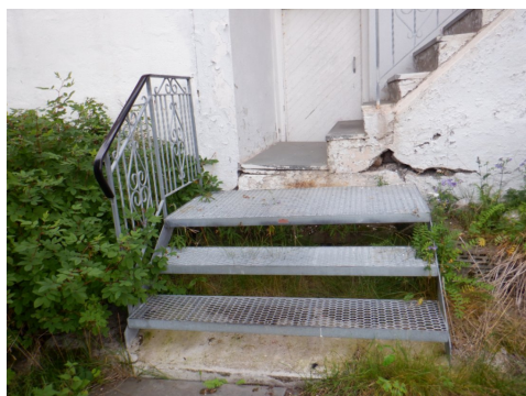
Skjevheter og store skader i betongtrapp.
