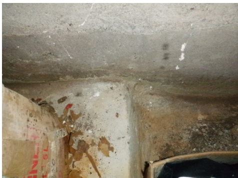
Saltutslag på betongdekke.
