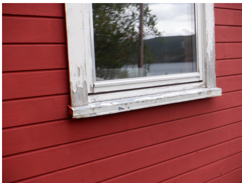
Råteskader og skader på vindusbrett.
