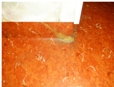
Skade på våtromsbelegget.
