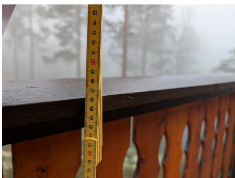
Rekkverk ca 87cm, krav ved byggetidspunkt 90cm
