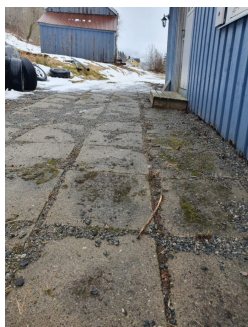
Terrenget faller inn mot bygningen.
