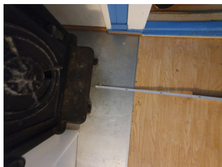
Plate under vedovn kjøkken stikker ut 25cm.
