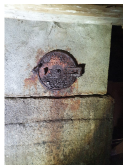
Sotluke i "potetkjeller" mye rust.
