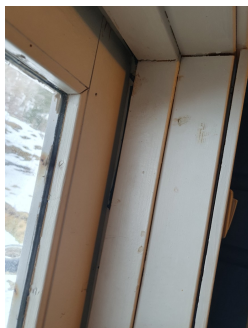
Inngangsdør er skjev og tetter dårlig.
