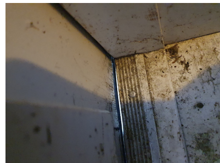
Tetter dårlig ved terskel.
