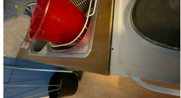
Mangler endelaminering av benkeplate.
