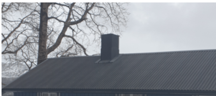
Taket mangler takstige og snøfangere.
