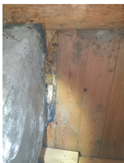
Ved pipe er det synlig never som tetting rundt pipe.
