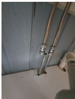
Vannrør er ikke tilkoblet gjelder vask på bad.
