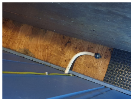
Avrennings slange går til avløp på bad.
